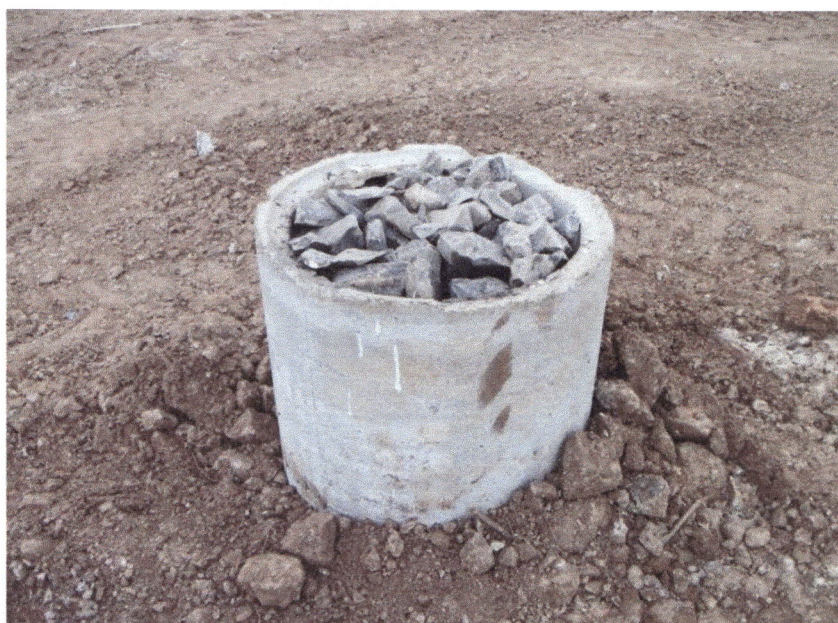
Figura 6 - Dreno de Gás
